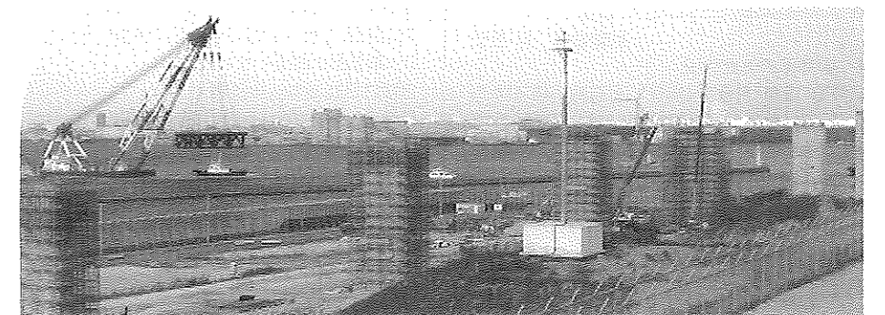
中央防波堤外側埋立地分場側アプローチ橋梁整備状況(平成19年11月20日撮影)
